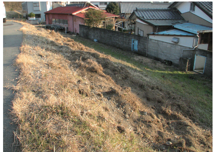
図-4 渡良瀬川における堤防掘り返し被害
