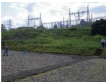
裸地と緑地を有する変電所
