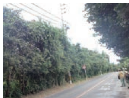
各家庭に電気を届ける配電線
