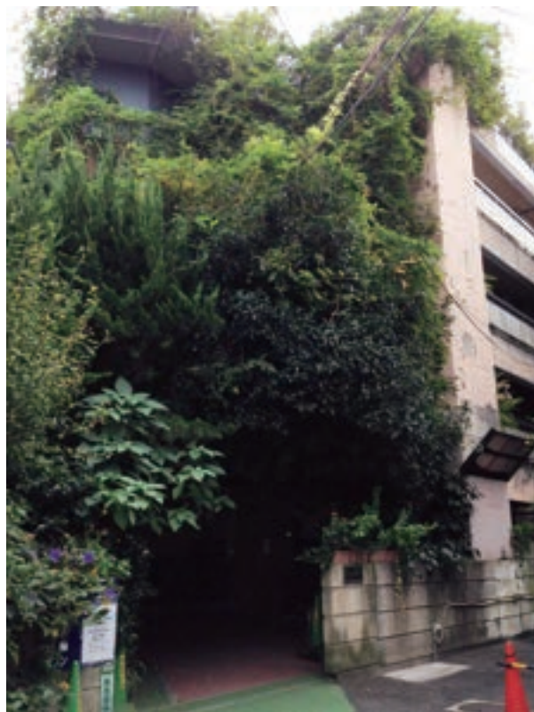
写真-1 アパートの壁面を覆い尽くしたつる植物
