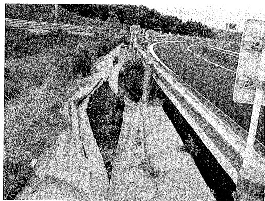
図-5 不織布系シートの破損状況
