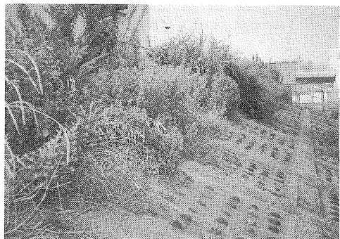
写真-3 2年間放置されたのり面
