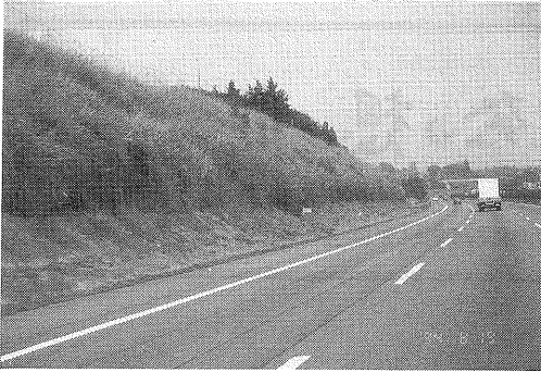
写真3. 高速道路法面の雑草
