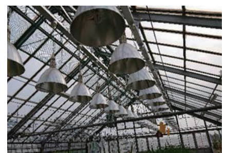
図-8 メタルハライドランプが設置された専用温室
