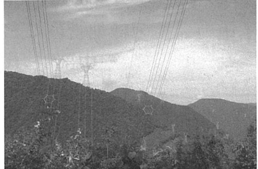
写真-2 山間地の鉄塔と送電線
